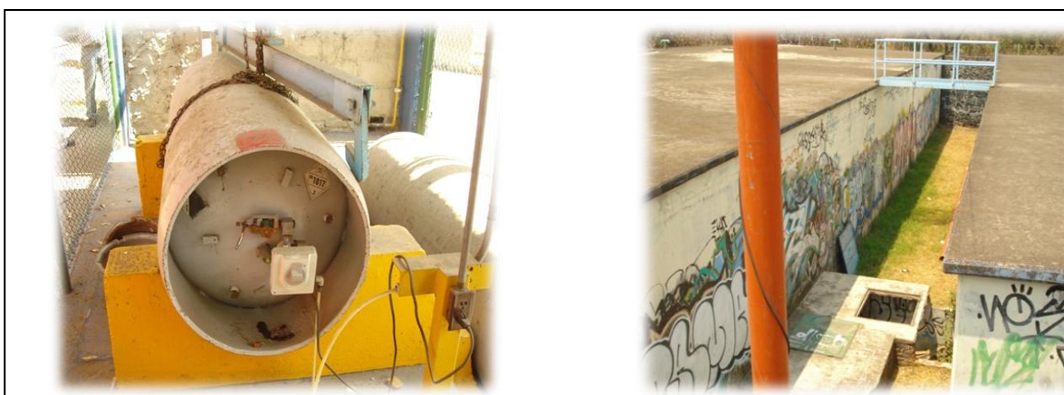
a) Sistema de desinfección en pozo multifamiliar b) Tanque vivero alto
