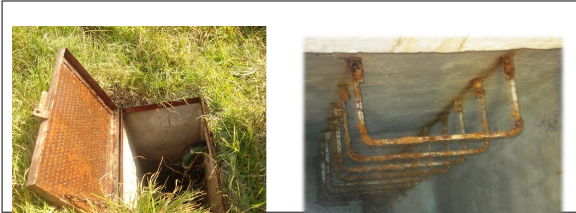
a) Tapa de cisterna ubicada en el almacén puerta 4 Av. del Imán b) Escalera submarina corroída ubicada en la cisterna del Instituto de investigaciones en materiales.
