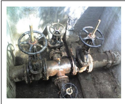
Figura 3.16. Crucero de la red de distribución de agua potable. Línea de 10" con derivaciones a 4".
