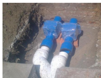
Figura 5.14. Válvulas check para evitar el regreso de agua del drenaje a la cisterna.
