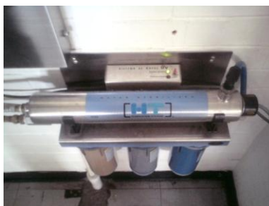
Figura 5.12. Lámpara de luz UV contra microorganismos para potabilización de agua.
