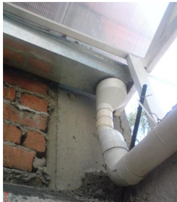
Figura 5.2. Canaleta de zinc y tubería de PVC.
