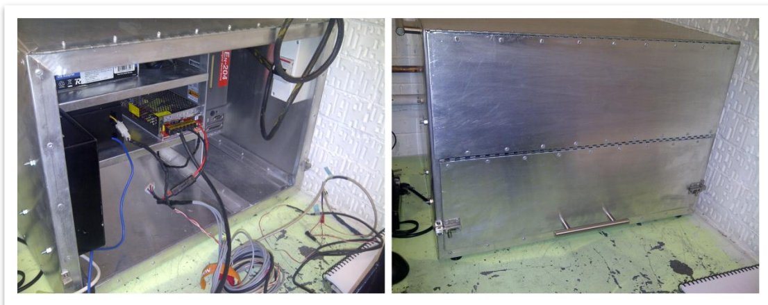
Figuras 5.10 y 5.11 Fotografías de gabinete eléctrico.
