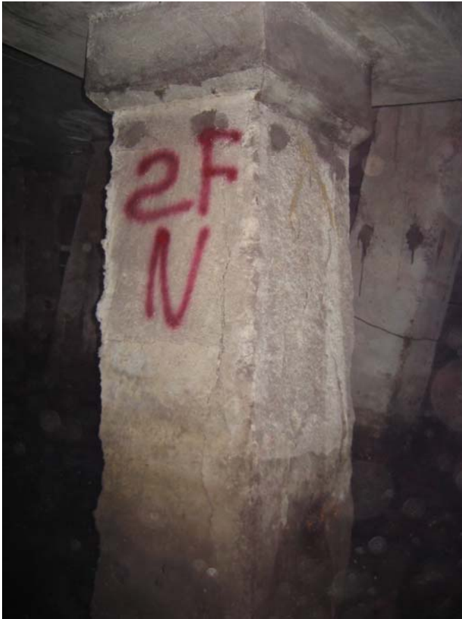
Figura 15. Pilote dañado clasificado nivel bajo "fisuras"
