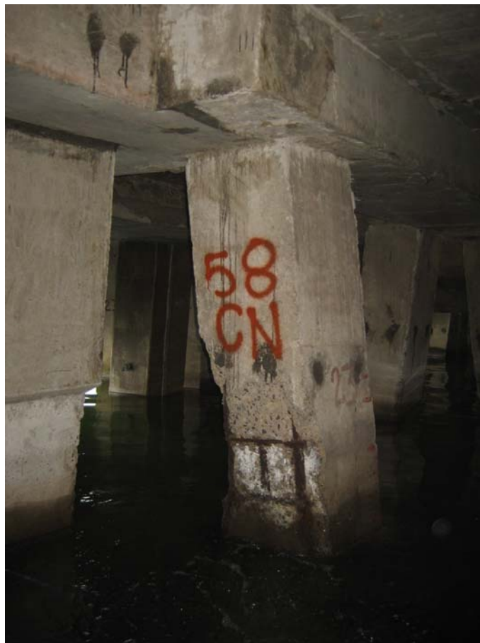
Figura 14. Zonas de afectación.
