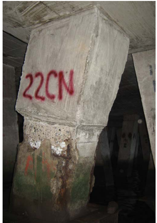
Figura 16. Pilote dañado clasificado nivel medio "daño parcial"
