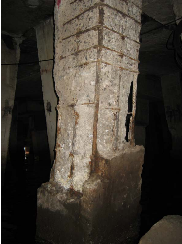
Figura 17. Pilote Pilote dañado clasificado nivel alto “daño total”
