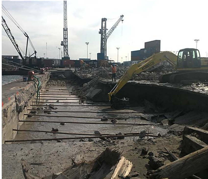
Fig. 1 Rehabilitación del pavimento del muelle 7 sur en el puerto de Veracruz. Demolición y retiro de 7200m 3 de material, colocación de capa rompedora a base de pedraplen para superar nivel medio de marea como mejoramiento de la base del muelle. En este procedimiento se utilizaron excavadoras hidráulicas con capacidad de 1m 3 y alcance de hasta 5 m, además de martillos hidráulicos para los trabajos de demolición.
