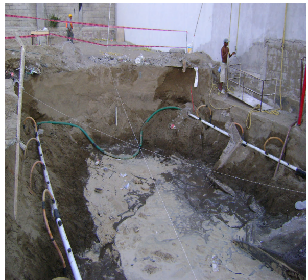
Sistema de bombeo de achique
