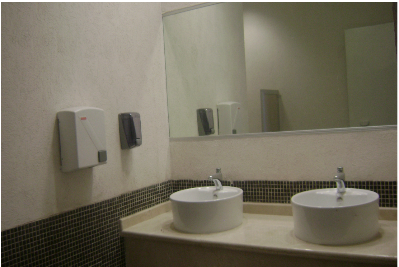
Colocación de espejo en muro y accesorios de aseo en zona de lavabos.
