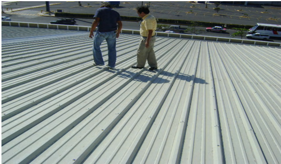
Inspección de losa multytecho de tienda Office Depot por filtraciones.
