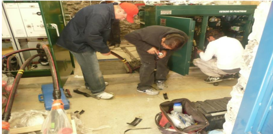
Figura.3. 24. Condición de la Subestación del Estadio de Prácticas.
