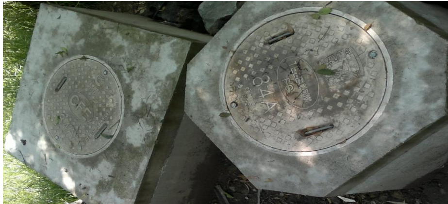
Figura.3.15. Registro Eléctrico (izquierda) y Registro de Comunicaciones (derecha).
