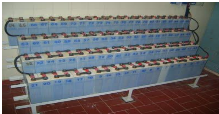
Figura 3.33. Espacio para baterías.
