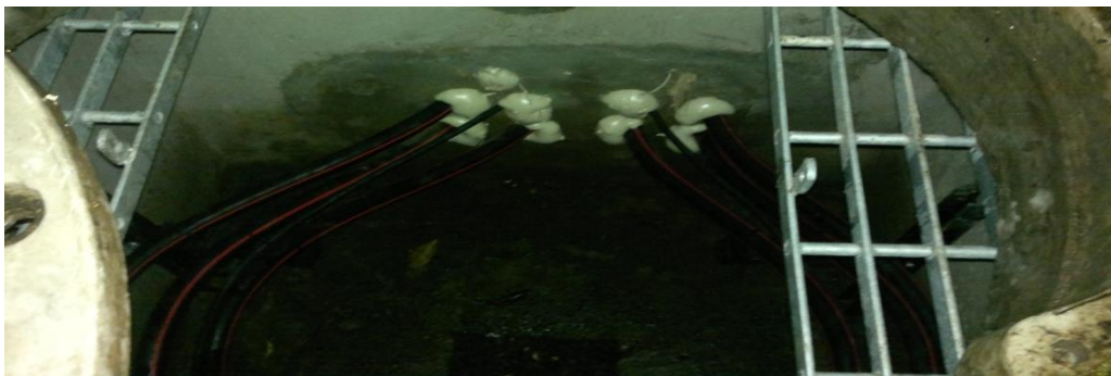
Figura 3.11. Conductores agrupados en modo adecuado.
