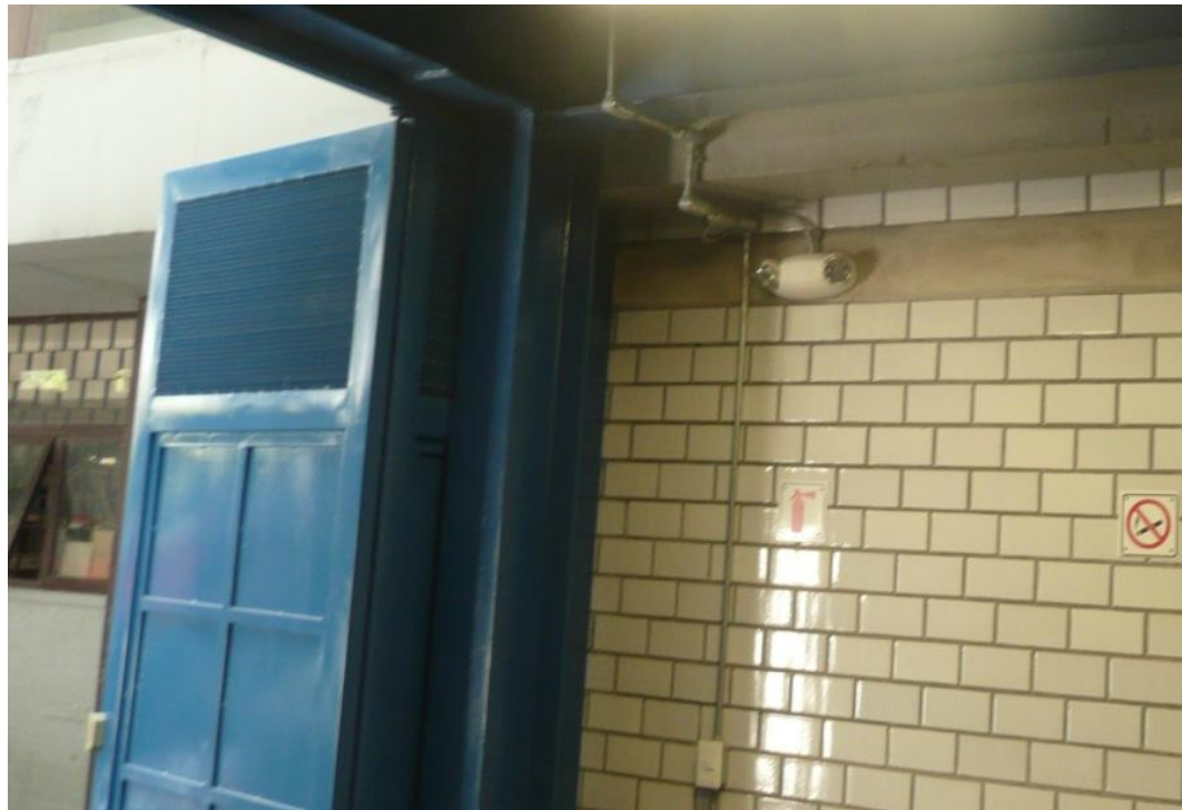
Figura 3.30. Puerta de acceso y salida de una subestación.
