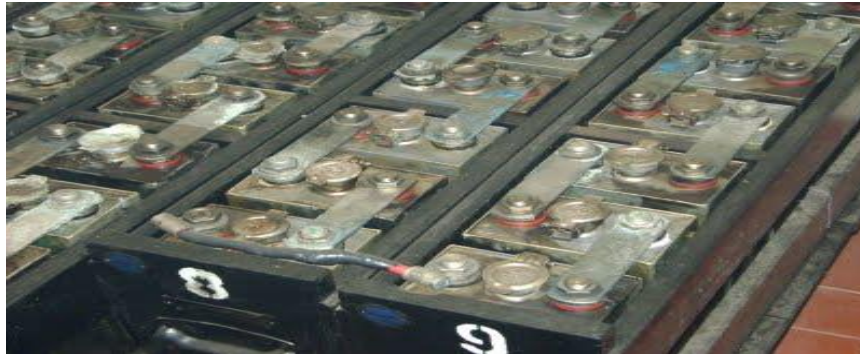
Figura 3.34. Locales de baterías.
