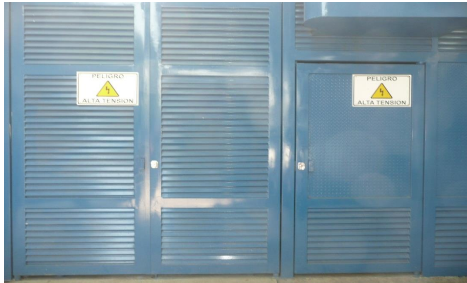
Figura 3.31. Aviso con la leyenda “PELIGRO ALTA TENSIÓN”.
