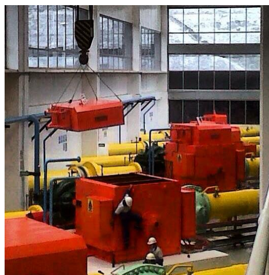
Imagen 2.12. Bombas de la Planta No. 5
