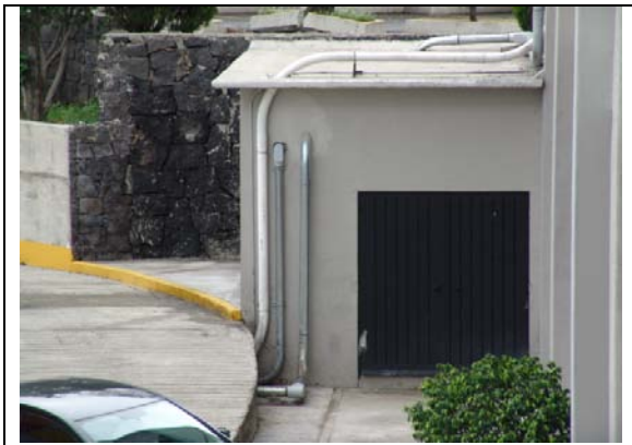
Local de los transformadores normal y de emergencia
