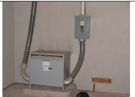
Transformador de 112.5 KVA y su interruptor conectado al tablero normal.
