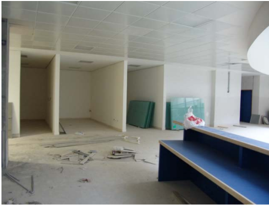
Colocación de plafón seccionado a base de charola lisa de 61x61 cms. en consulta externa.
