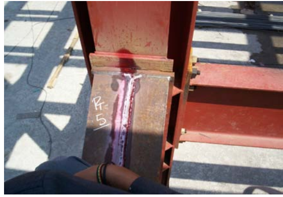
Prueba de líquidos penetrantes
