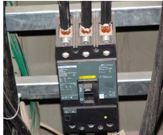
Interruptor general de emergencia conectado a barras
