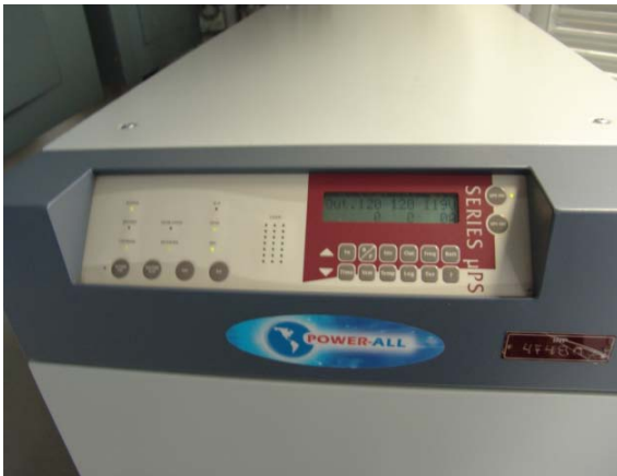
Vista de la pantalla de los equipos en funcionamiento.
