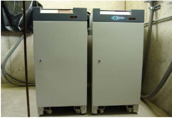
Vista de los UPS
