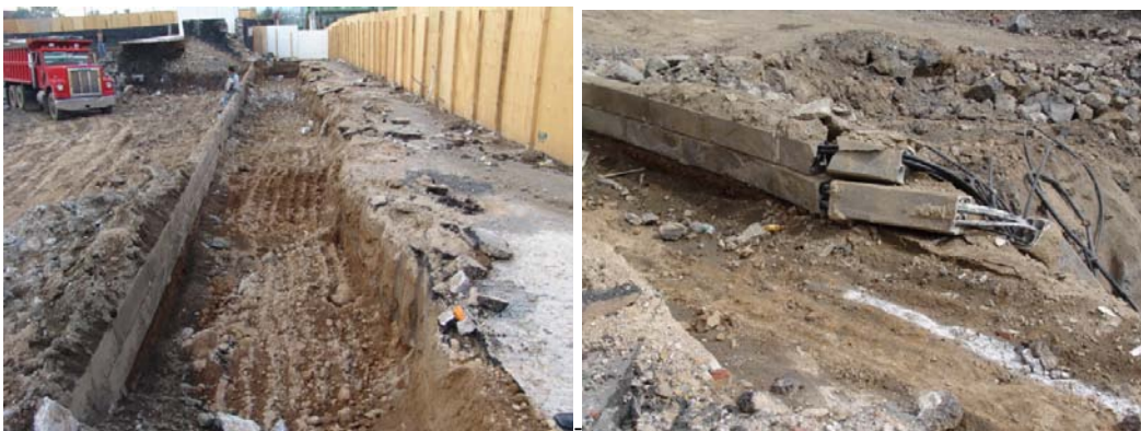
Instalaciones de Telmex ubicadas en la banqueta propiedad del Instituto
