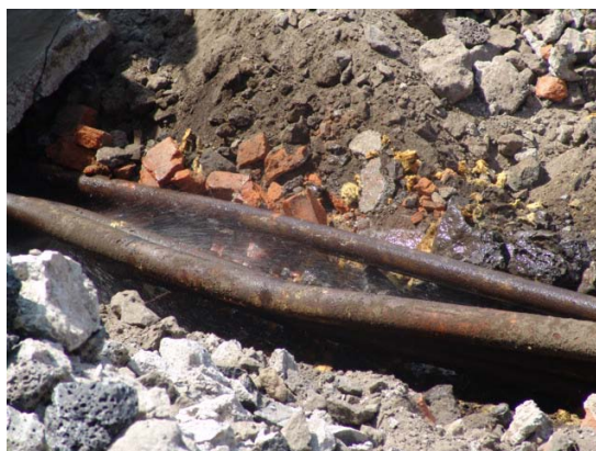
Tuberías de agua potable de la Casa Hogar
