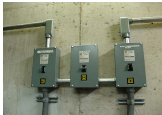
By-pass de los interruptores
