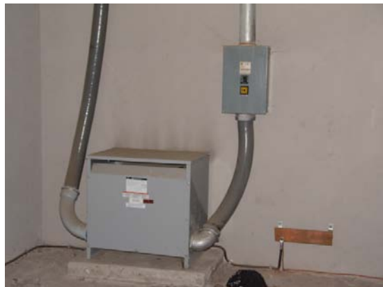
Barra de tierra conectada
