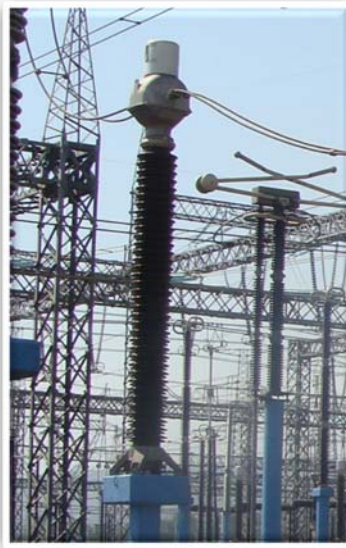
Figura 1.2.3.- Transformador de Corriente
