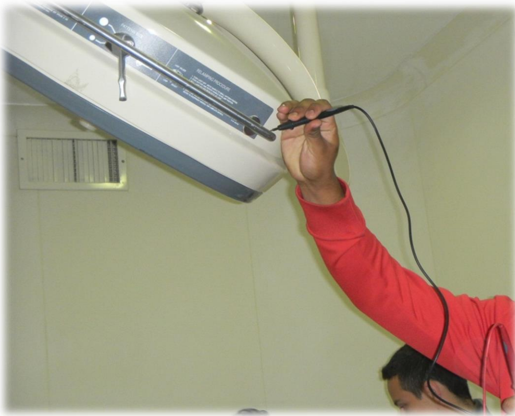
Figura 38. Medición de Continuidad en Partes Metálicas de la Sala de Operaciones.
