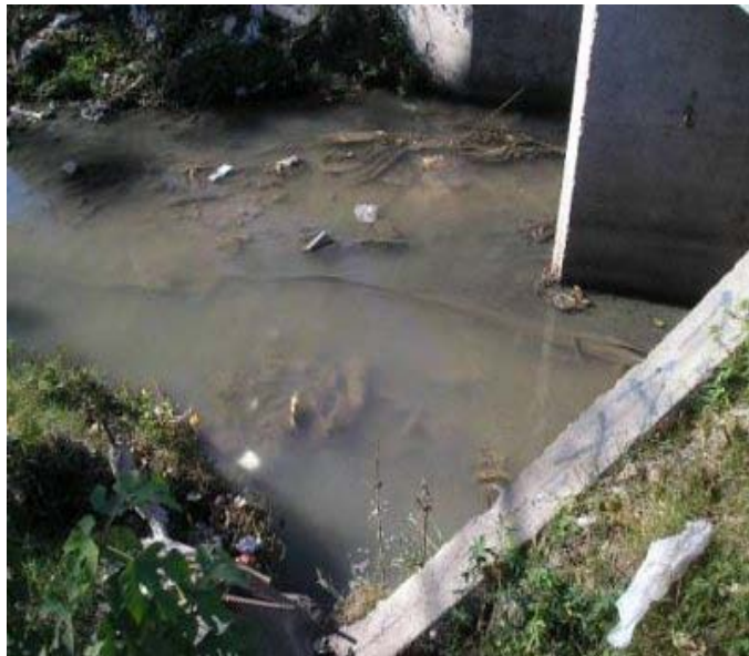
Figura 3.12 En algunos sitios las aguas residuales siguen siendo vertidas en crudo a las corrientes que desembocan en el vaso de la Presa. (Fuente: Comisión de la Cuenca de Agua para el Valle de México, CONAGUA).
