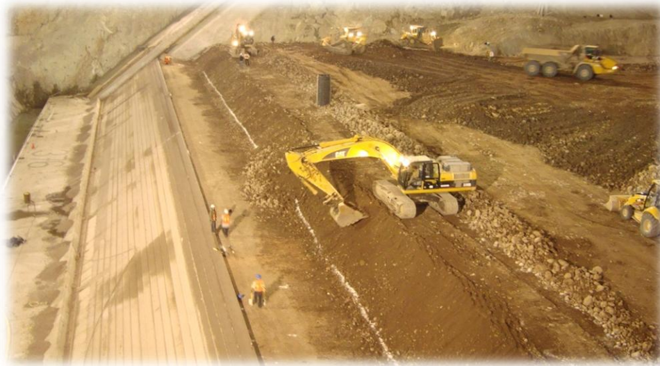
Figura 3.14 Retroexcavadora afinando el talud del respaldo de material 3B para el material 2 en el P.H. La Yesca.
