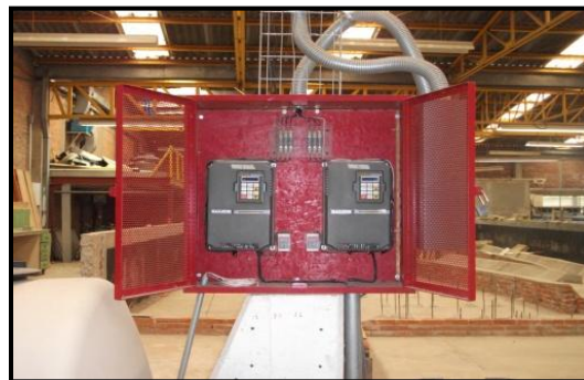
Fig.2.6 Variadores de frecuencia.
