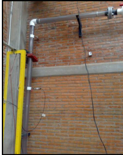
Fig.2.3 "Riser" y línea de descarga al separador.
