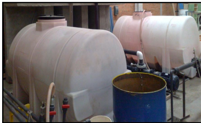
Fig.2.4 Tanques de almacenamiento de aceite (derecha) y agua (izquierda).
