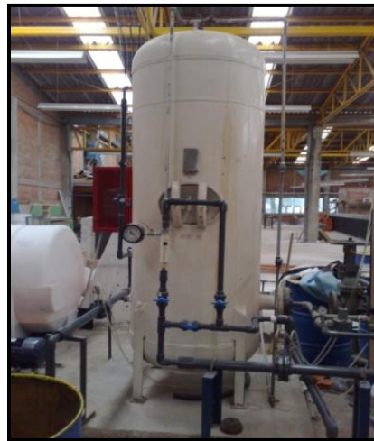
Fig.2.11 Tanque acumulador de aire.
