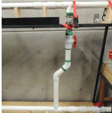
Figura 14. Válvula de regulación de gasto del circuito hidráulico
