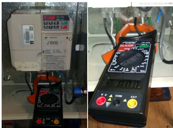
Figura 25. Disposición del multímetro digital de gancho en el control de la bomba
