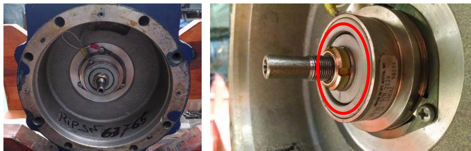
43. Encoder sin alguna intervención encotrador en un servomotor.
