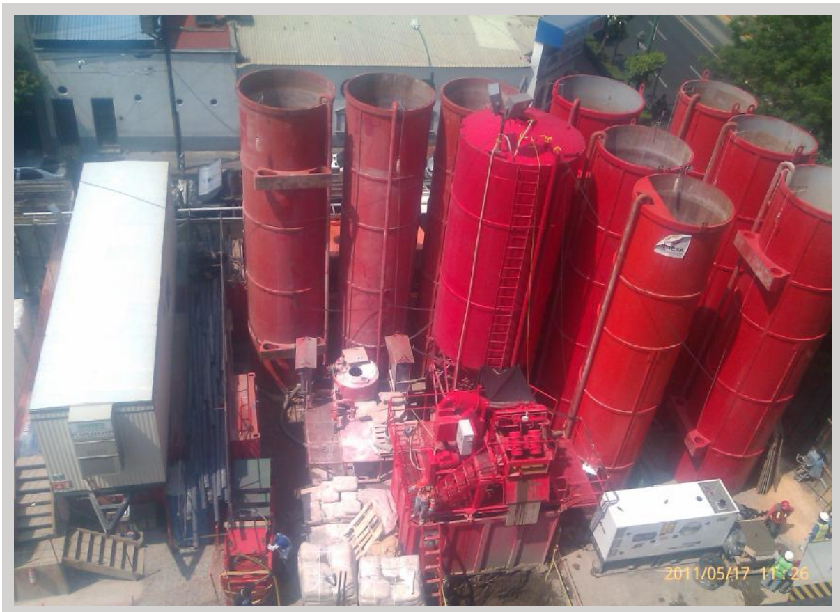
FIGURA NO. 9 Central de Lodo de excavación
