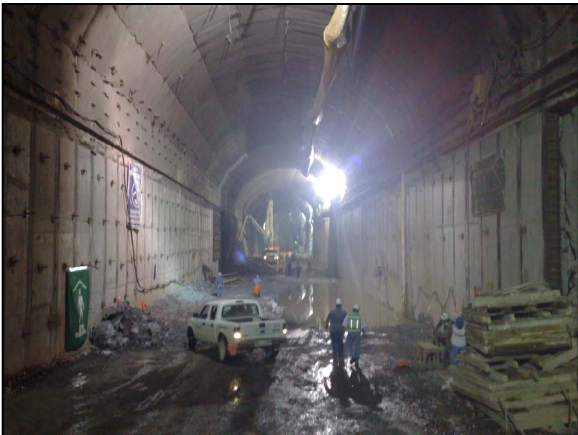
Figura 7.23 Últimos trabajos del revestimiento primario en la sección constante- media sección inferior
