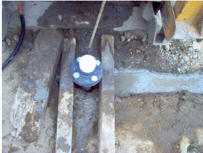
Figura 68. Extensómetro de barras previo a la inyección de lodo fraguante.
