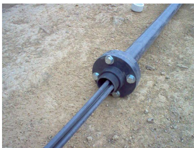
Figura 67. Tubo de protección unido al cabezal del extensómetro.
