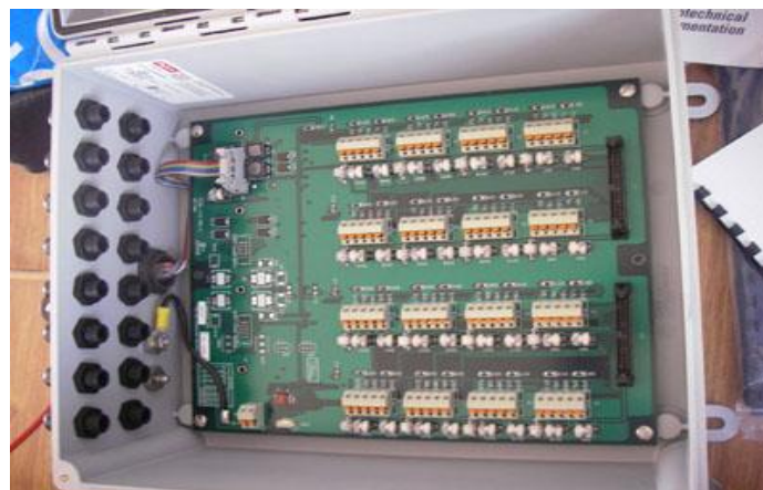
Figura 37. Parte interna del Multiplexor.
