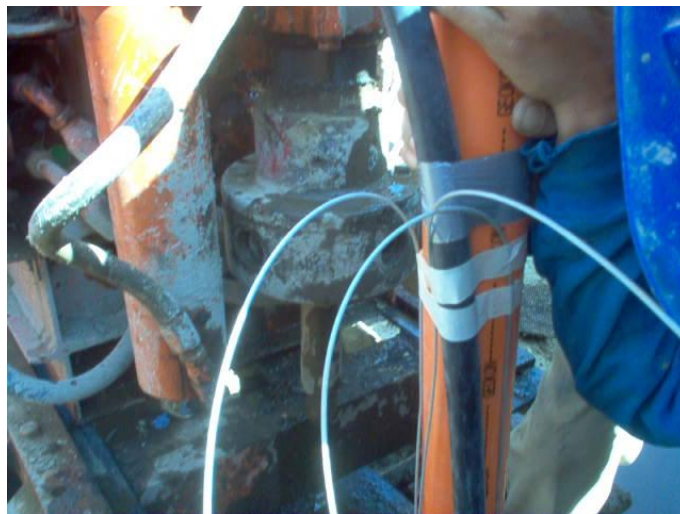
Figura 73. Vista de poliducto de inyección y cables de acero adosados en tubería ABS.
