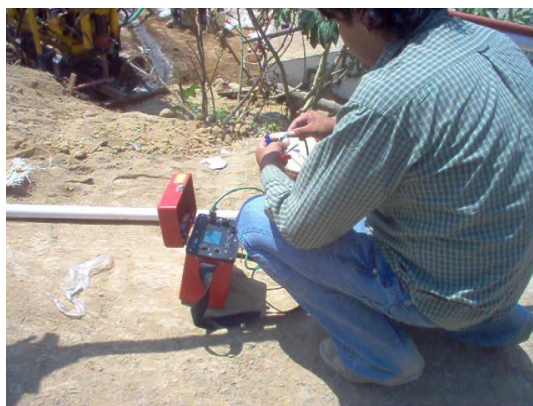
Figura 78. Toma de lectura cero del piezómetro de cuerda vibrante.
