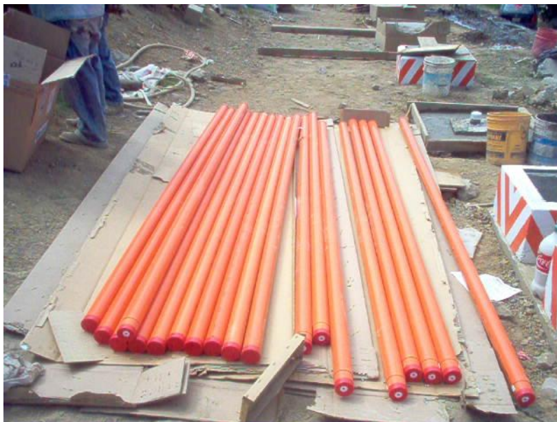
Figura 62. Vista de tubería para inclinómetro.
