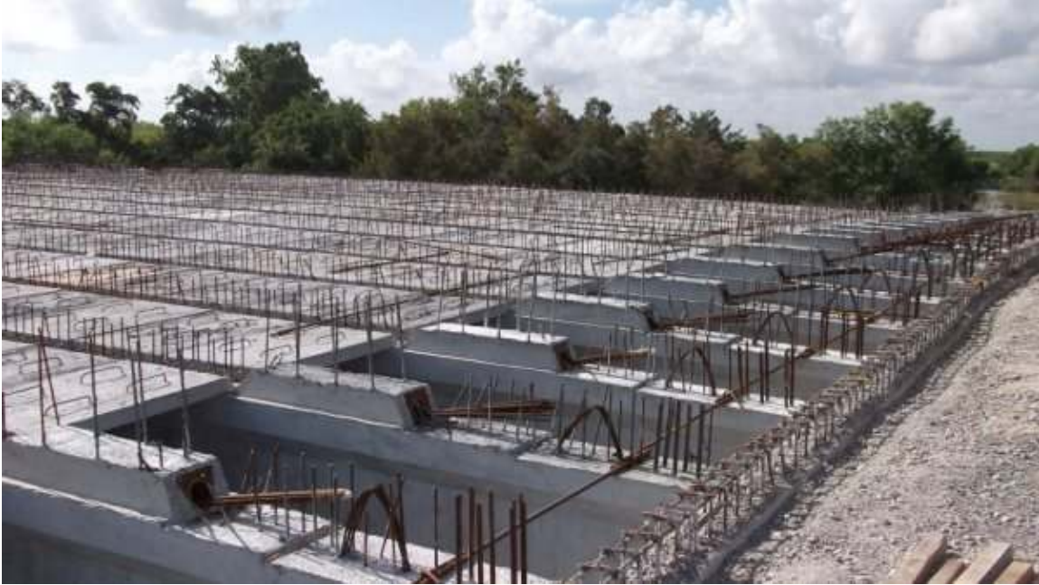
Trabes colocadas en su sitio con la losa precolada, se observan los torones de postensado.
