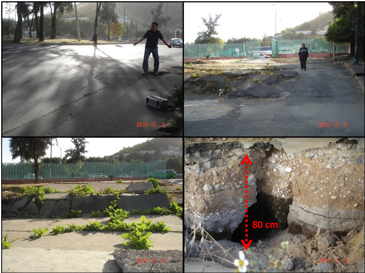
Figura 3.8 Zona Norte Peñón del Marqués. Superior izquierda: medición con acelerógrafo en las grietas presentes, sobre Av. Zaragoza. Superior derecha e inferior izquierda: daños en la carpeta asfáltica. Inferior derecha: tamaño del desnivel presente a simple vista.
