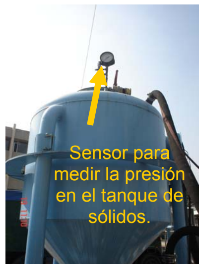
Fig. 2.14. Tanque de almacenamiento de los sólidos.
