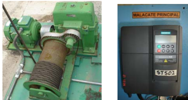
Fig. 2.45. Inversor del motor del malacate principal.
