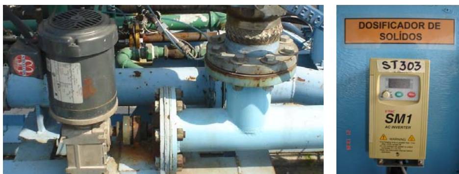
Fig. 2.44. Motor e Inversor del dosificador de sólidos
