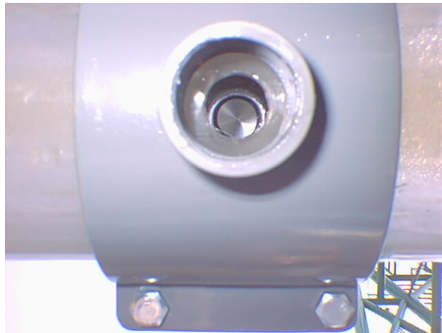
Fig. 2.18. Colocación del sensor de presión en la tubería experimental.
