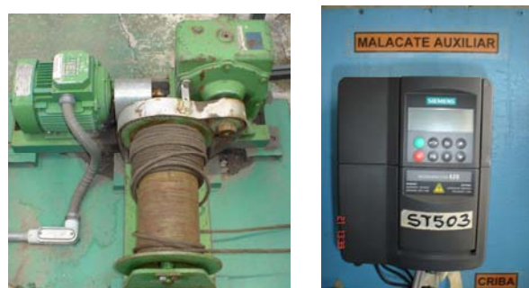
Fig. 2.46. Inversor del motor del malacate secundario.
