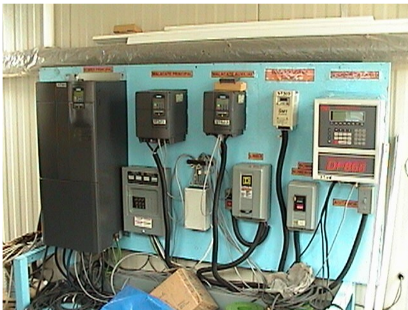
Fig. 2.42. Panel de potencia.
