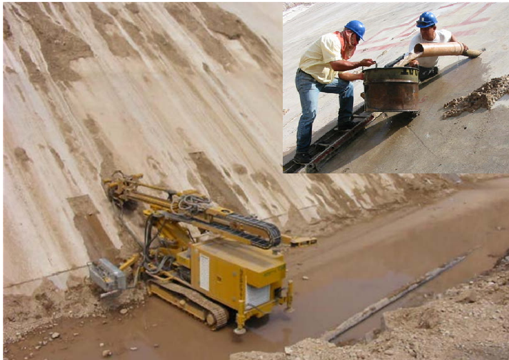
Figura IV.9 Barrenos de drenaje en la losa L-22.
