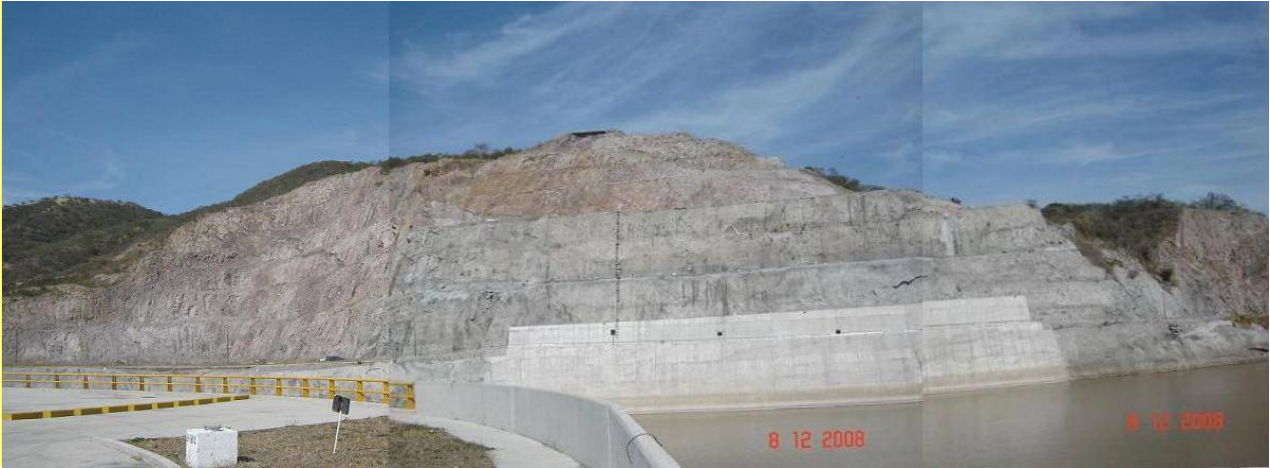
Figura V.3 Tratamientos en el talud derecho del canal de llamada de la obra de excedencias
