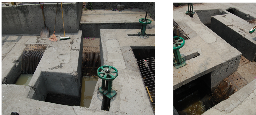
Fig. 2.8 Colectores de agua residual de la PTARCU
