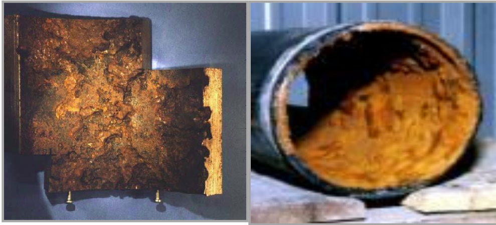
Fig. 1.2 Daños provocados por la corrosión.
