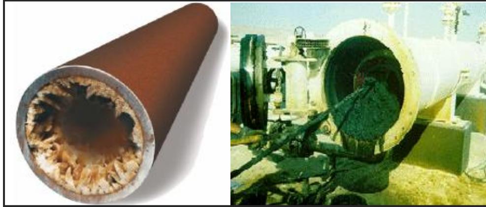
Fig. 1.1 Incrustación y acumulación de lodos en ductos.
