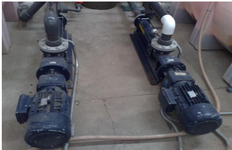
Fig. 2.3 Equipo de bombeo para agua y aceite.
