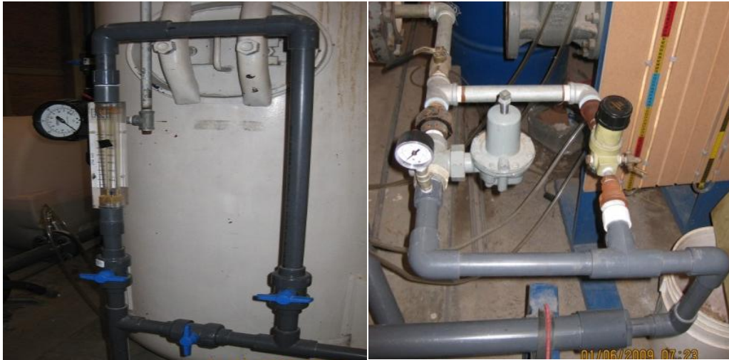
Fig. 2.6 Manómetro, rotámetro y válvulas reguladoras de presión.
