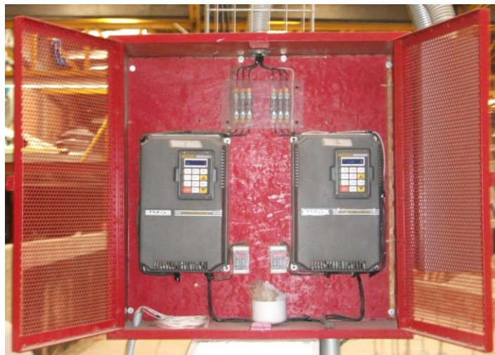
Fig. 2.4 Variadores de frecuencia.
