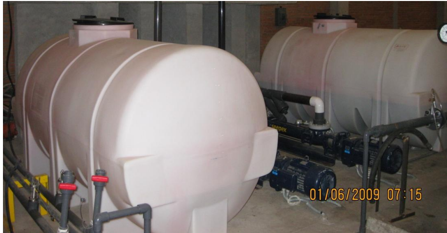
Fig. 2.2 Tanques de almacenamiento de agua (izquierda) y aceite (derecha).
