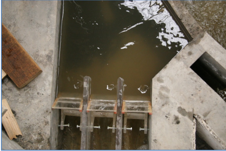
Fig. 5.2.6.3 Presencia de vórtices en compuertas TEC
