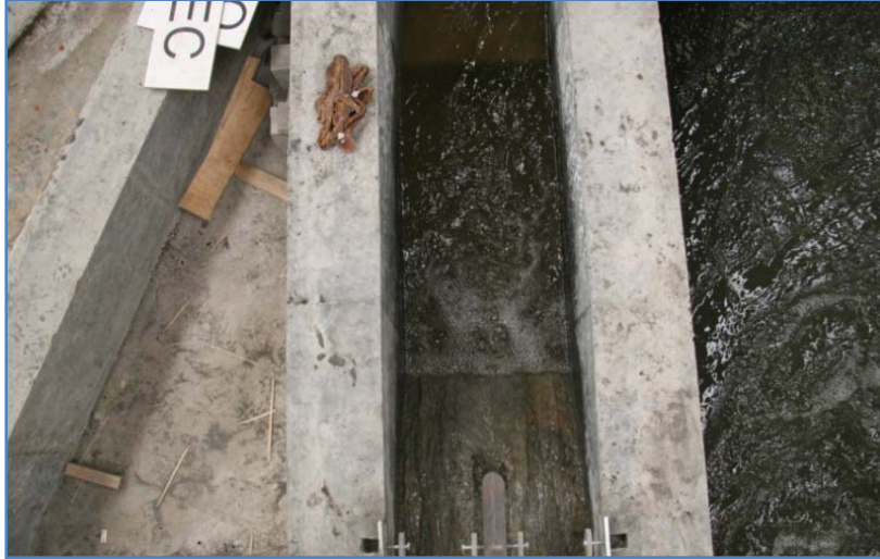
Fig. 5.2.5.4 Rápida del TEO funcionando en condiciones de diseño (170 m 3 /s) dejando pasar 25 m 3 /s a la zona de alcantarillas
