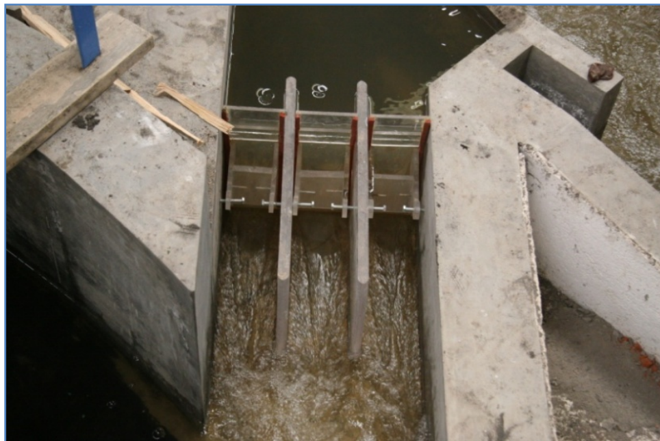
Fig. 5.2.6.4 Compuertas operando para descargar 25 m 3 /s a la zona de alcantarillas
