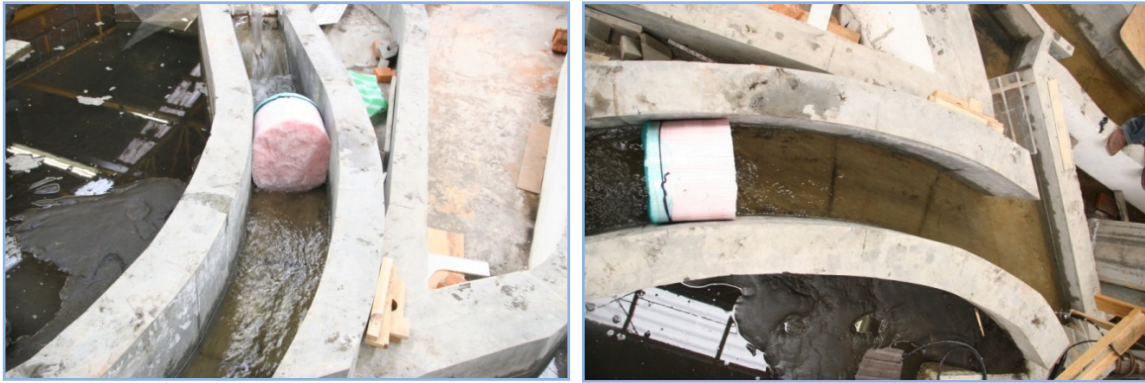
Fig. 6.4.1.1 Estructura 1 Disipador a la salida del tanque amortiguador
