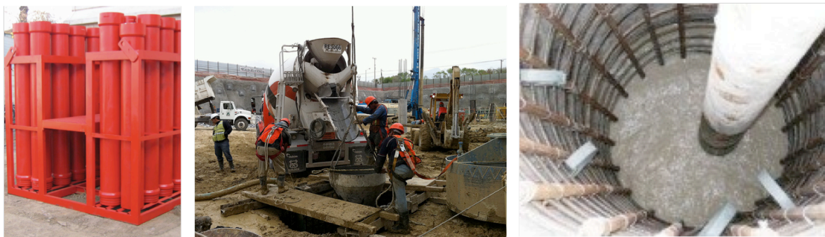
Fig. 68. Izq. Tubería Tremie SPIT&T. Medio y Der.:Vaciado de concreto en la perforación con tubería Tremie
