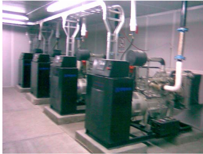
Figura 1.2. Recuperadores acoplados a motores con biogas
