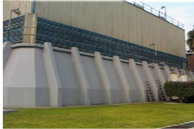
Figura 2. 10 Torre de enfriamiento de la industria farmacéutica Dr. Reddy’s, Jiutepec, Morelos.
