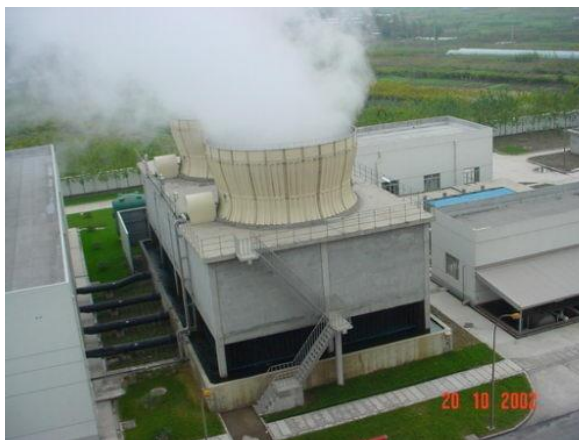
Figura 1.1 Torre de enfriamiento.
