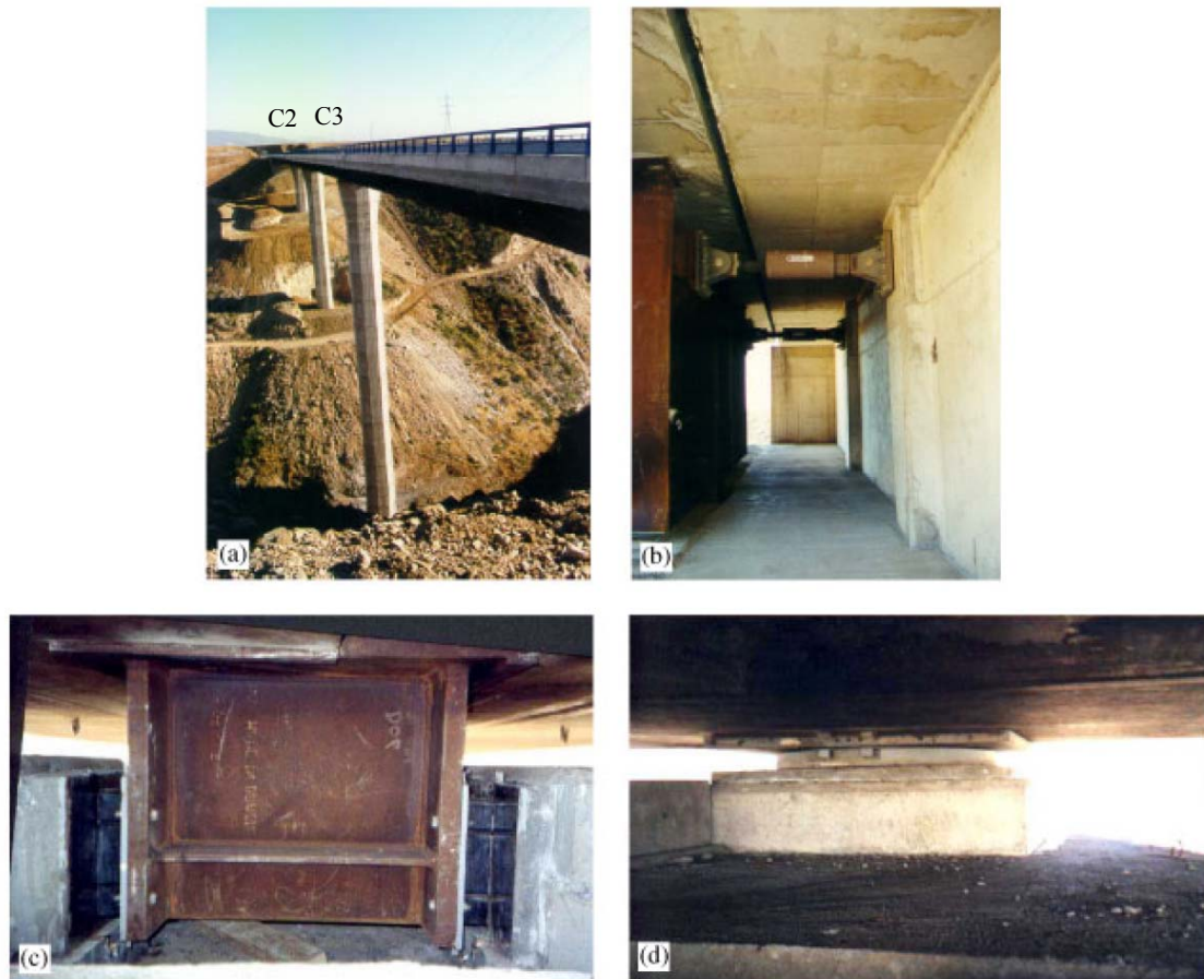
Figura 4.19 Puente Amolagas: (a) Vista panorámica general (b) amortiguadores (c) apoyos deslizantes y (d) apoyos de fricción (Sarrazin et al. , 2005)
