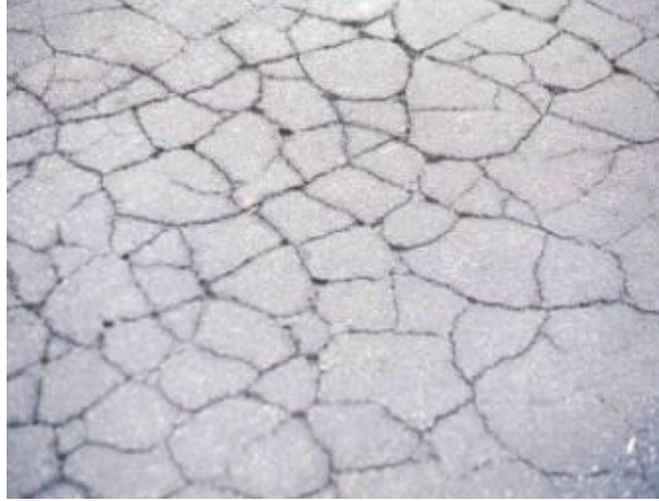
Figura 2.8. Agrietamiento por fatiga en la carpeta
