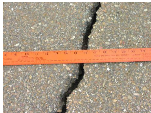
(b) Espesor de la grietas
