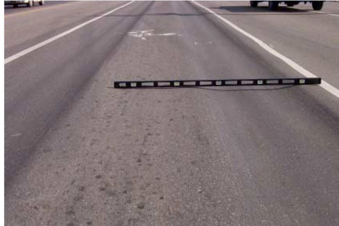
Figura 2.12. Roderas sobre la carpeta asfáltica
