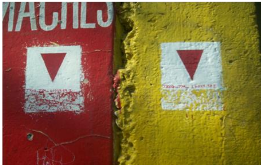
Fig. 1.7. Testigos en muros (palomas)
