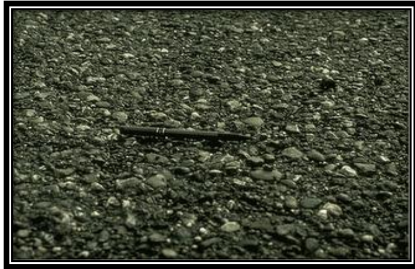
Fig. 2.3 Desprendimiento de agregados
