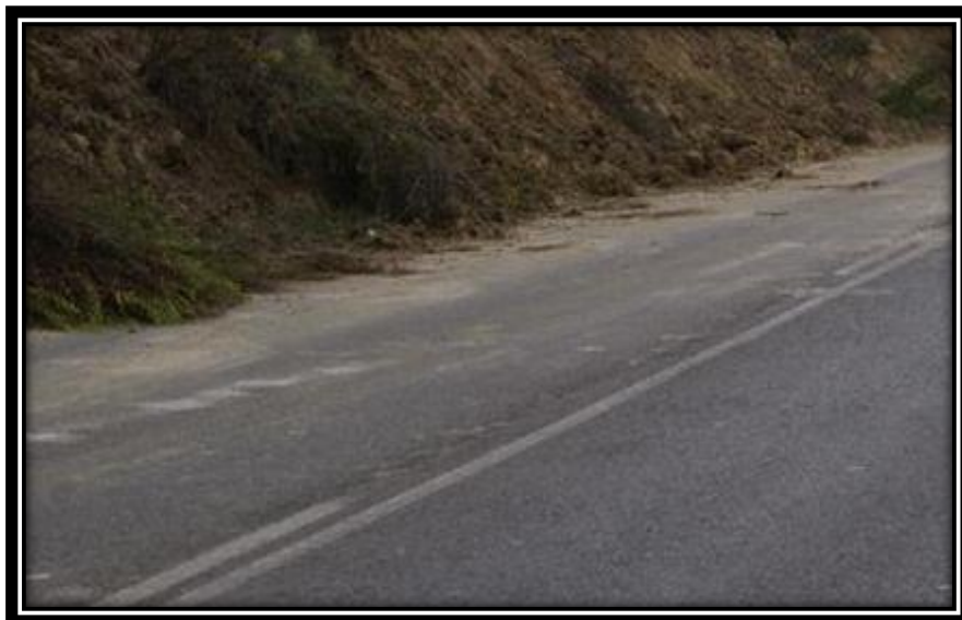
Fig. 2.23 Obstrucción del drenaje por desprendimiento de rocas o caídos
