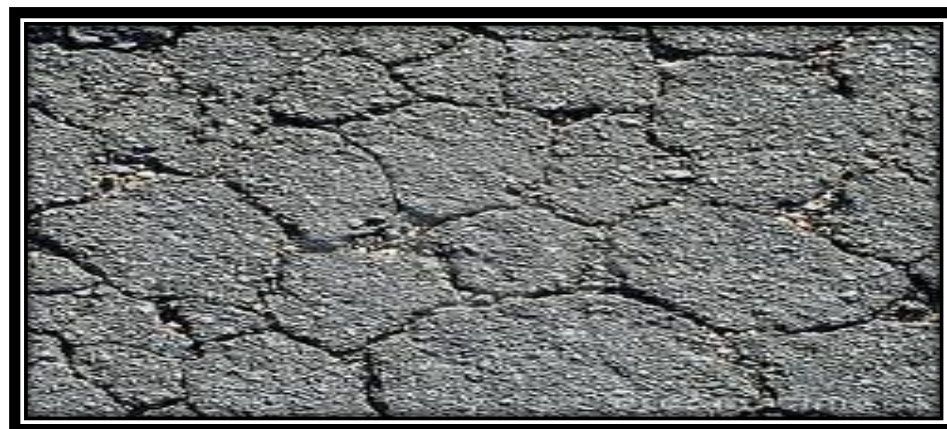
Fig. 2.15 Agrietamiento piel de cocodrilo
