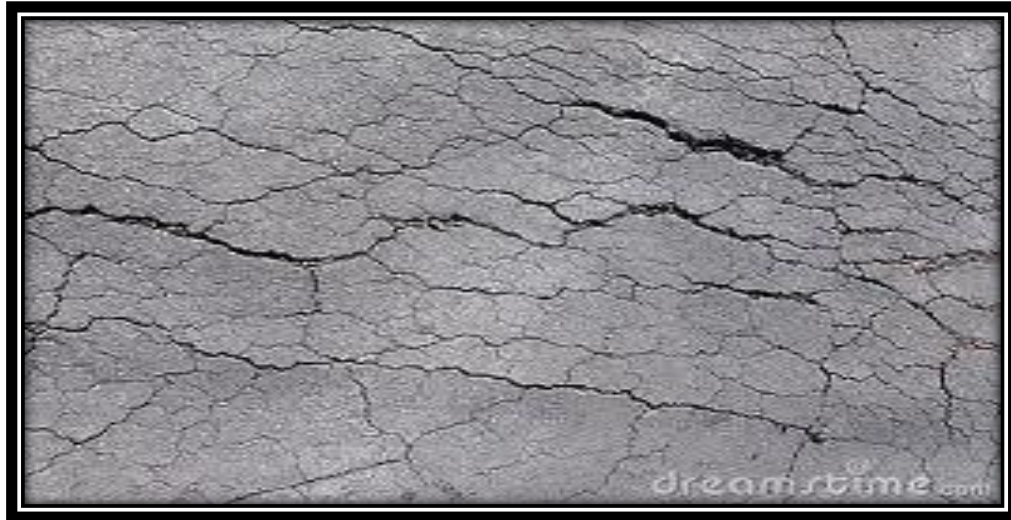
Fig. 2.16 Agrietamiento tipo mapa
