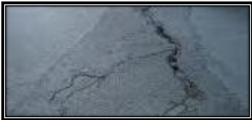
Fig. 2.13 Grieta errática o en zigzag
