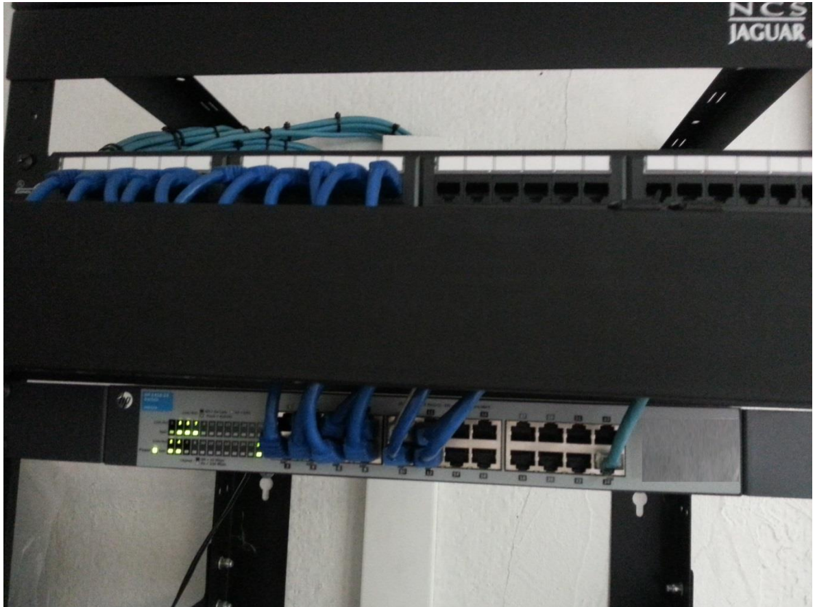
Figura 3.22. RACK de datos para Aula Magna
