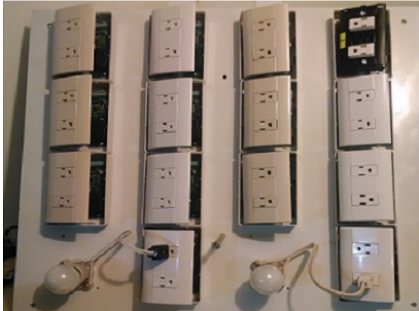
Figura 4.7. Panel de controladores.
