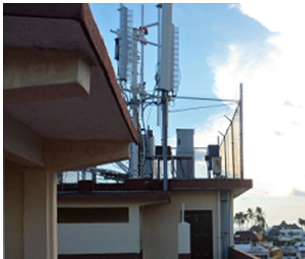
Figura 4.14. Antenas en el techo del hotel.
