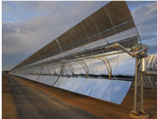
Figura 2.8 Planta Termosolar en España Fuente: TORRESOL ENERGY®
