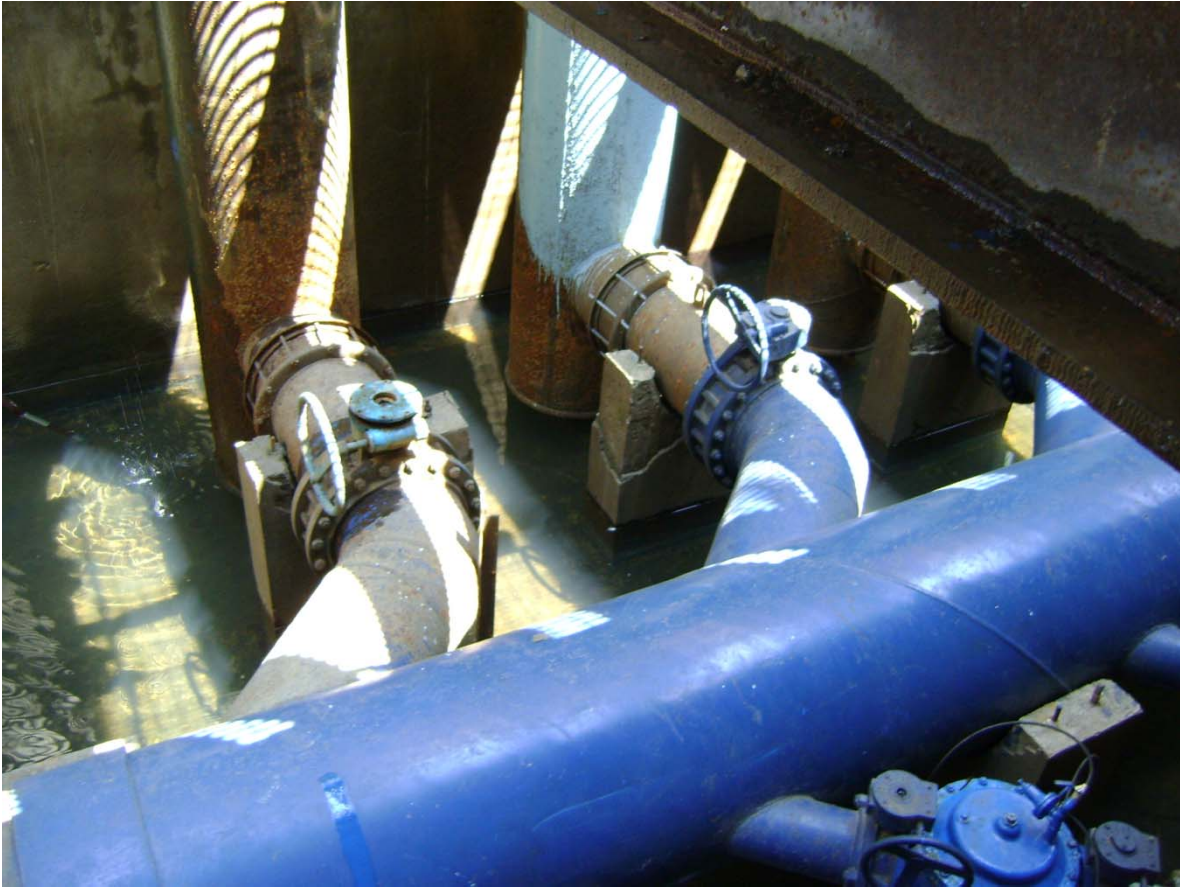
Figura 3 Interior cárcamo seco
