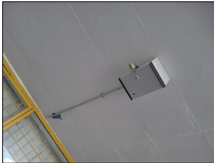
Figura 3.49. Access point en jaula de seguridad
