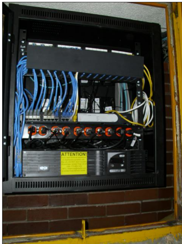
Figura 3.42. Gabinete de nivel
