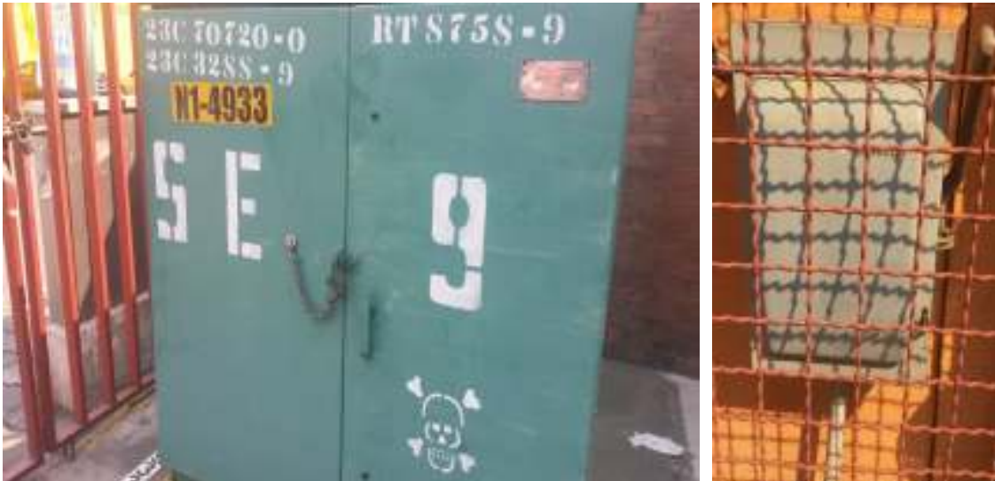
Figura 34. Transformador tipo pedestal (izquierda) e interruptor general (derecha).
