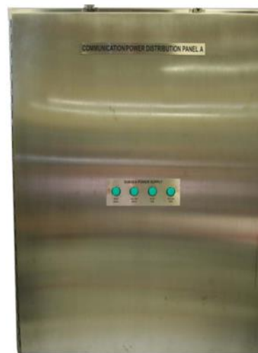
Ilustración 67 Unidad de suministro de potencia interrumpible A y B
