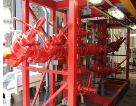
Ilustración 57 Árbol de válvulas del Standpipe
