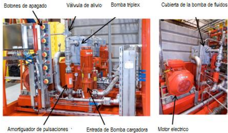
Ilustración 62 Unidad de Potencia Hidráulica
