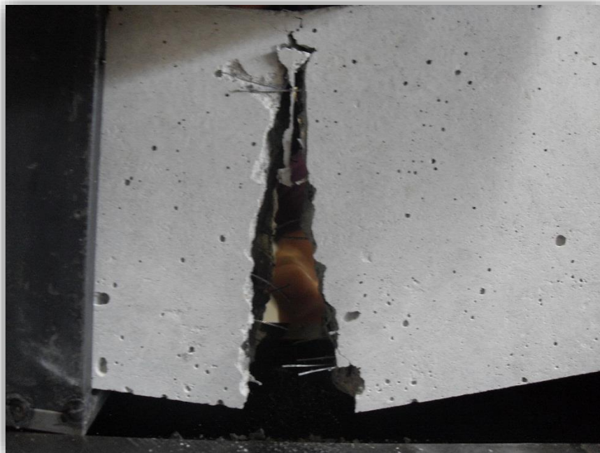
Figura 6.3.1.3b Falla del elemento después de la aplicación de la carga máxima de la viga VFA1
