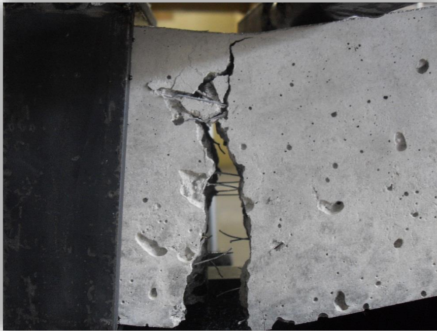
Figura 6.3.2.3b Falla del elemento después de la aplicación de la carga máxima de la viga VFA2
