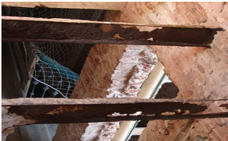
Figura 8.1.1 Perfil estructural corroído
