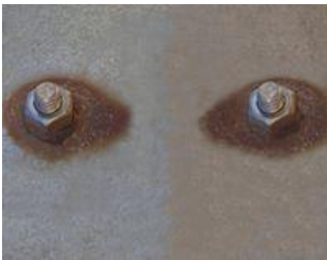
Figura 8.1.2 Corrosión galvánica en el perfil
