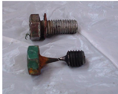
Figura 8.1.2 Corrosión galvánica en el sujetador
