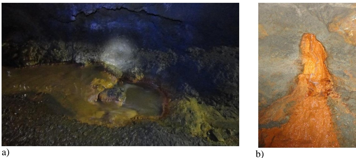
Figura 26. a) Coloración amarilla sobre la rampa Sur. b) Oxidación de la roca presentando una coloración rojiza.
