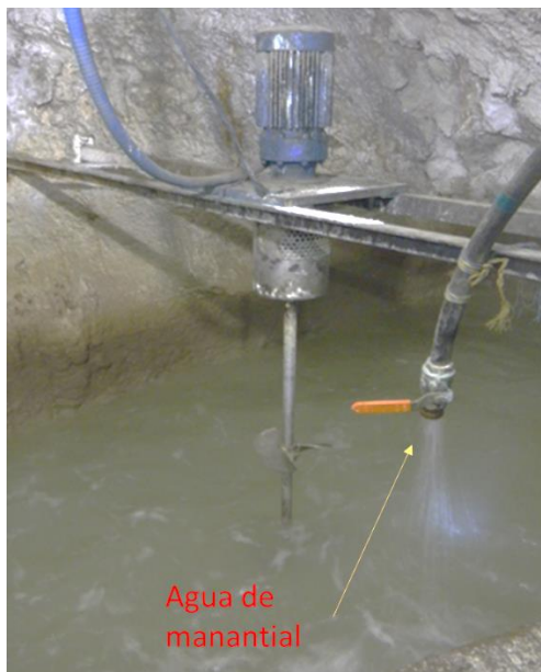
Figura 49. Pileta de mezclado. Planta de tratamiento
