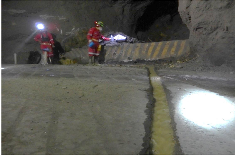
Figura 42. El agua que se desborda por el muro de concreto, es canalizada mediante una acequia que cruza la rampa para de manera posterior incorporarse a la acequia principal.
