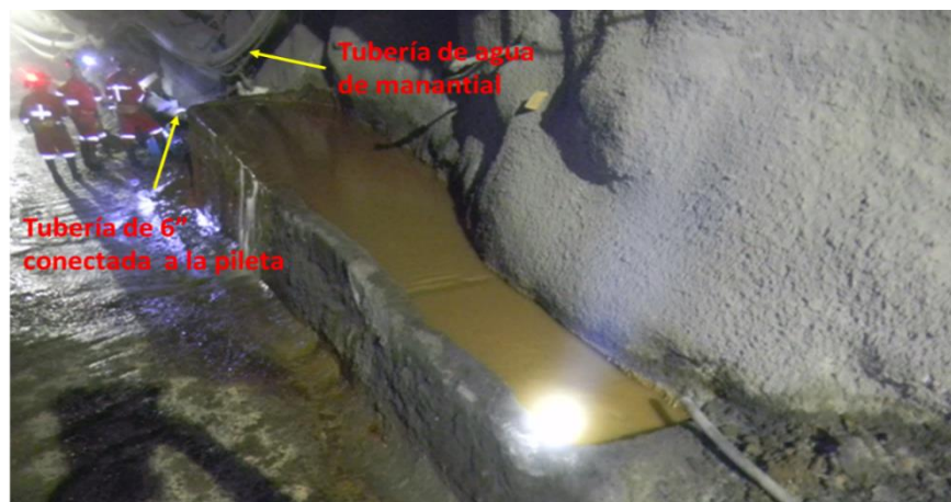
Figura 48. Disposición de tuberías en la pileta. Rampa Sur
