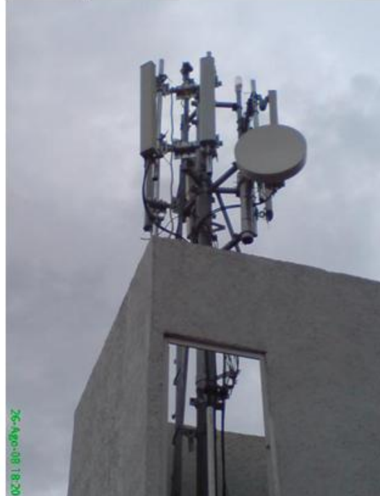
Figura 2.5 Antenas UMTS Instaladas.
