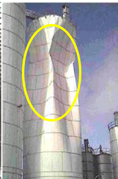
Fig. 3.2 Falla de silo metálico por problemas de flujo en carga y descarga. Tomado de Ref.2 “Causas de Daños y fallas en silos”
