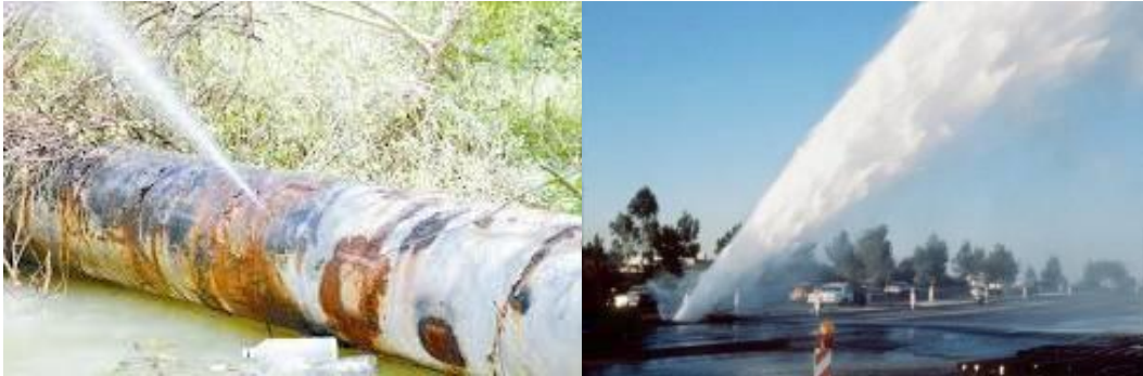
Figura 3.4 Fugas con alta presión en la tubería
