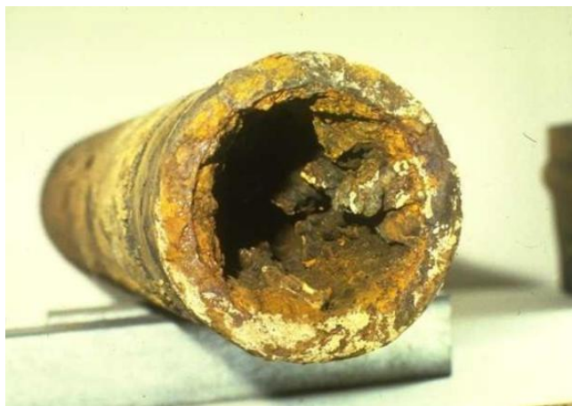
Figura 3.7 Corrosión externa e interna por edad de las tuberías
