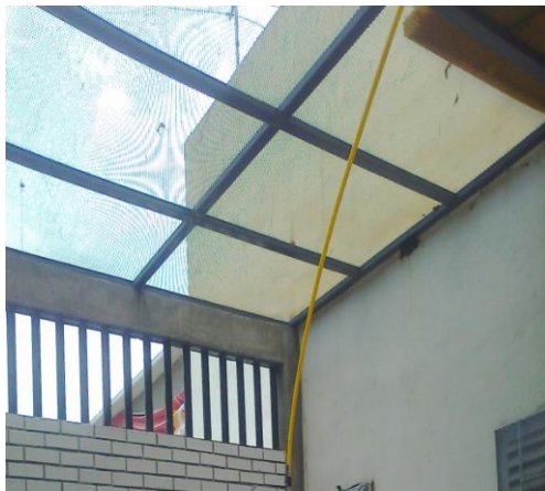
Figura 3.14 Parte superior de la planta de biogás
