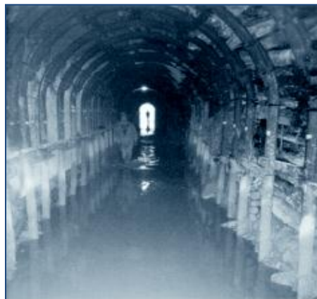
Figura II-11.- Canal de derivación en Túnel. Fuente: Comisión Europea, (1998) Manual para una pequeña hidráulica.
