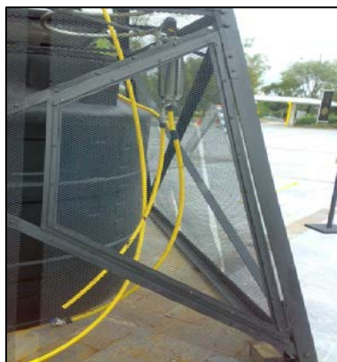
Figura 4.11 Tubería de interconexión entre los sistemas
