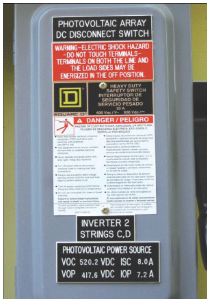
Figura 41. Ejemplo de desconectador marcado adecuadamente.
