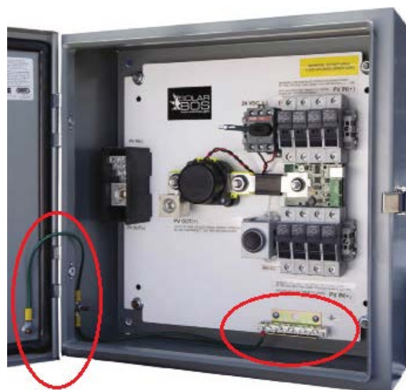
Figura 52. En esta caja combinadora se resaltan la terminal de los conductores de tierra (derecha) y los puntos de puesta a tierra de la caja y su tapa (izquierda), así como sus puentes de enlace.
